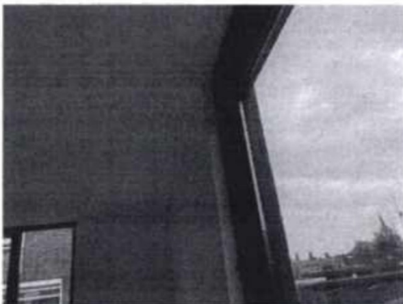
Foto 5. Hier is duidelijk te zien dat de totale dikte van deze muur afwijkt.
